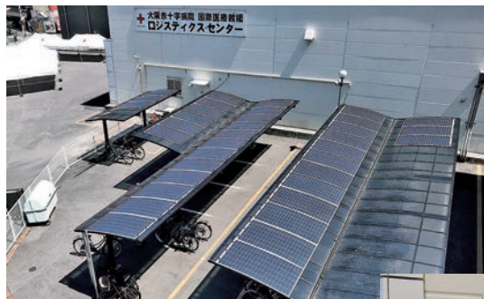
▲駐輪場の屋根に設置されている太陽光パネル
