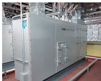
▲病院建物内の換気システム
